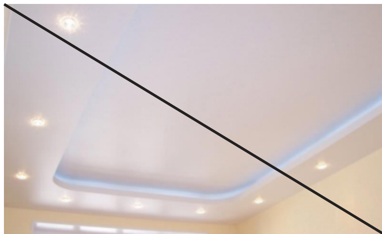
Плохо Многоуровневые гипсокартонные конструкции
